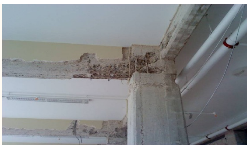
Σχήμα 1: Εικόνα αστοχίας κόμβου οπλισμένου σκυροδέματος [6]
